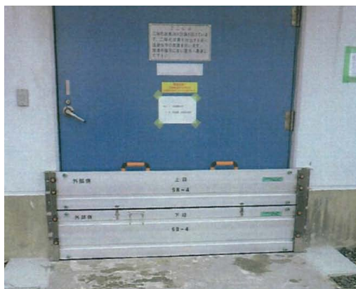
写真4 出入口の止水板
