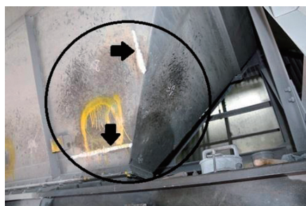
写真4 ダクト亀裂部
