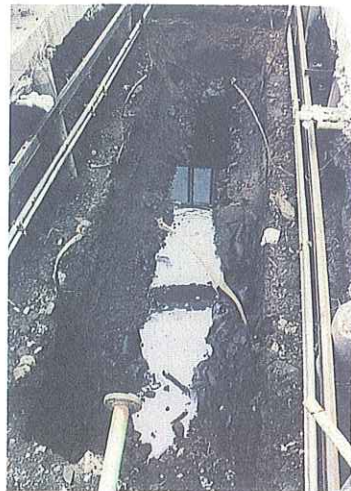
写真4 漏えい事故を起こした専用タンクを掘り揚げた時、専用タンクの基礎部分には、黒い油等が相当滞留している。
