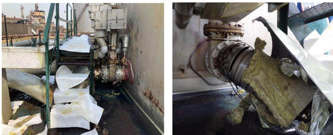
写真1 座屈・破損したフレキの状況
