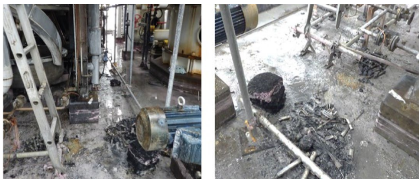
写真3 隣接する施設の焼損状況
