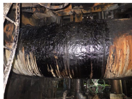
写真10 1階部分に漏れた重質油
