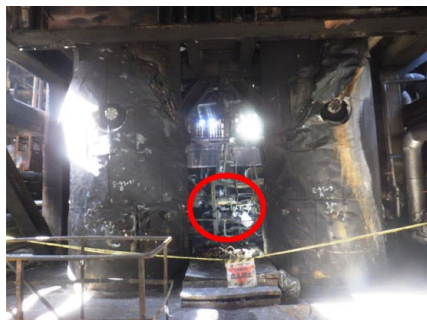
写真5 3階の火災発生箇所
