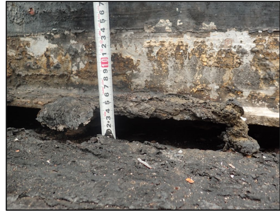
写真9 事故タンク底板の浮きの状況
