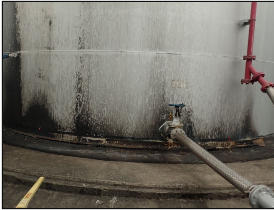
写真8 事故タンク外面の焼損状況
