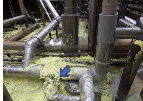
ノズル開孔箇所
