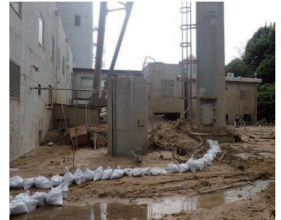
〈写真3〉 土砂流入による被害
