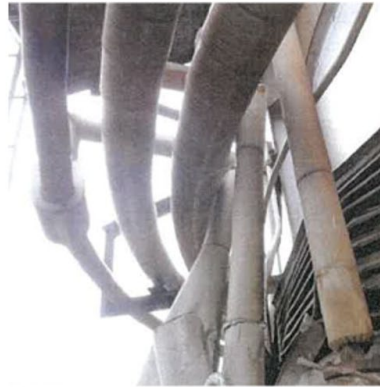
燃料ガス配管の変形
