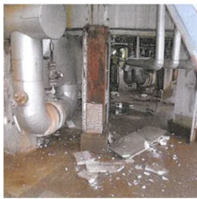
支柱耐火ボード剥離
