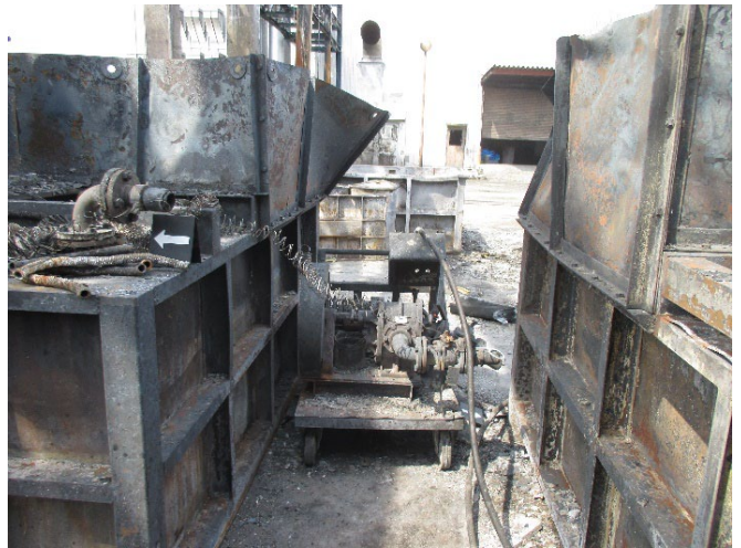
写真10 油槽に挟まれたポンプ
