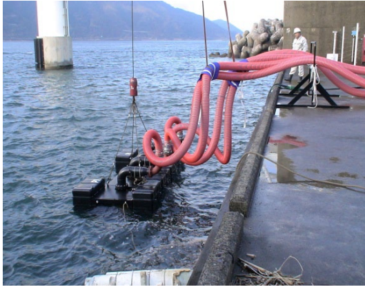
写真6 取水ポンプの例
