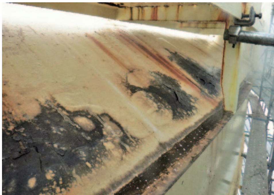
屋根の煤けの状況
