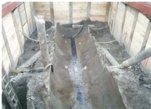
写真 2 倒壊した支柱
