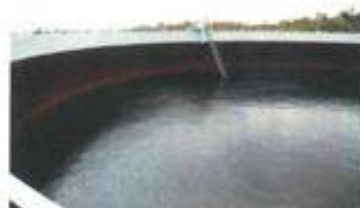
浮き屋根の沈下の状況
