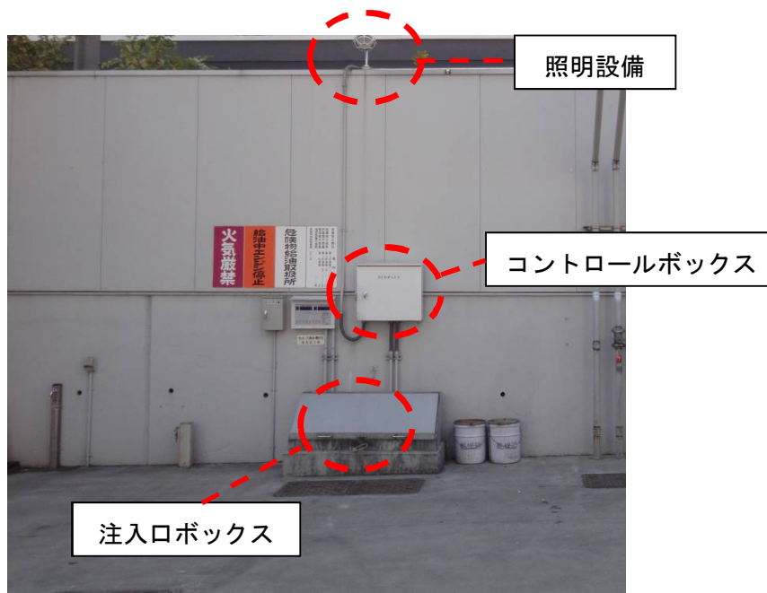
写真2.3.9 コントロールボックスの設置例
