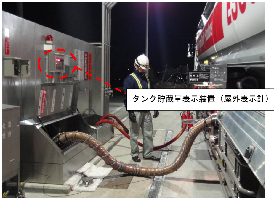
写真2.3.2 タンク貯蔵量表示装置（屋外表示計）の設置例
