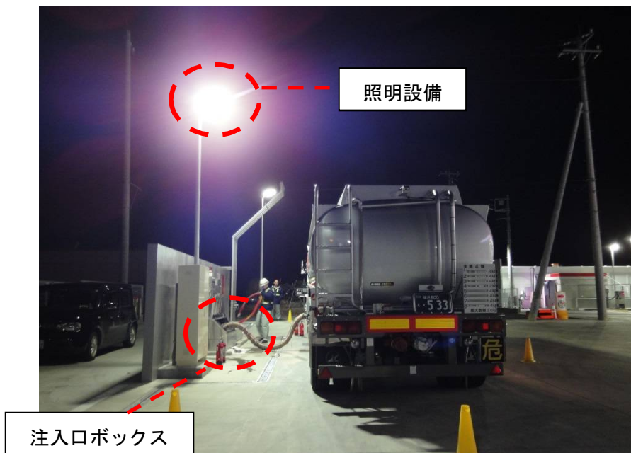
写真2.3.8 照明設備の設置例
