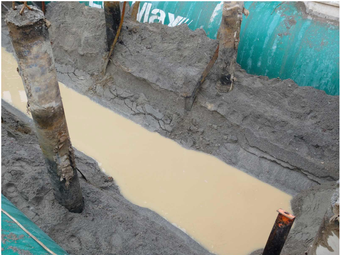
写真2. 1. 2 タンク撤去後の砕石基礎の状況（新潟県の営業用給油取扱所）
